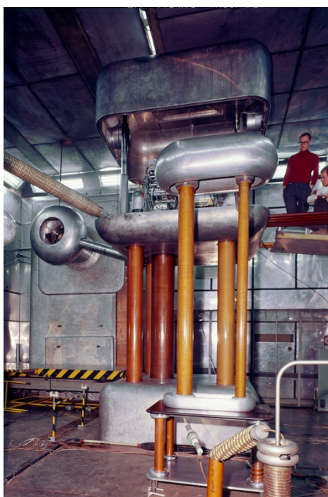
Fig. 2: The 520 kV Linac 1 HV generator
